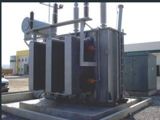
Transformador de 6.0/7.5 MVA, 115/13.2 kV, Planta Toshiba, Rosarito, B.C. Norte.
