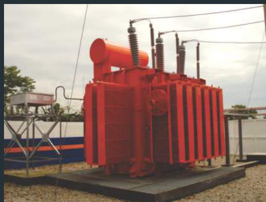
Transformador de 12/14/16 MVA, 115/13.8 kV ONAN/ONAF, 55/65 °C. para Planta Cryoinfra, Cárdenas, Tabasco.
