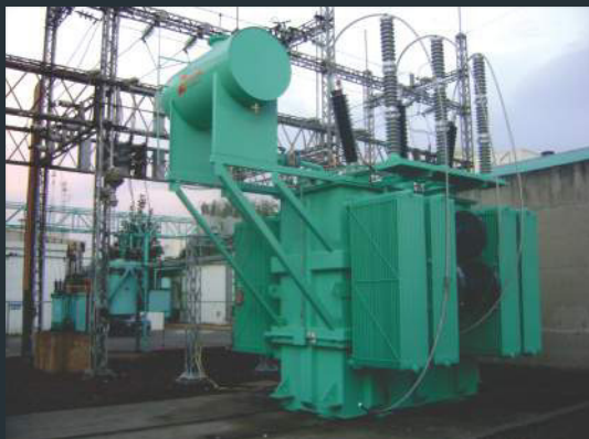
Transformador de 18/24 MVA, 115/13.2 kV, Planta Kiriú, Toluca.
