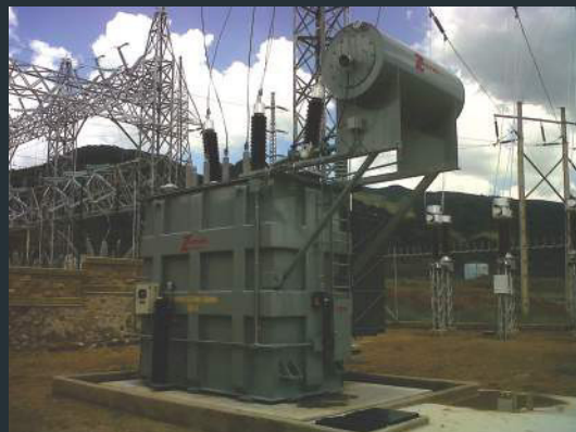
Transformador de 10/12.5/15 MVA, 115/13.2 kV, para Planta Ico, Talpa De Allende, Jalisco.
