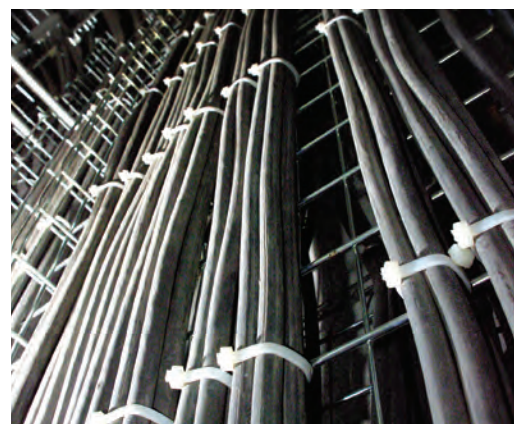
Instalación de cable monopolar tipo XHHW-2 LS en charola tipo malla: Arreglo Trébol
