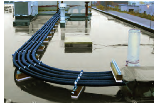
Instalaciones de cable tipo MC con chaqueta de PVC: En exterior
